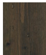
Praline Endommagé Poinçonné
